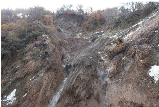
第2図 平成25年崩落の崖
