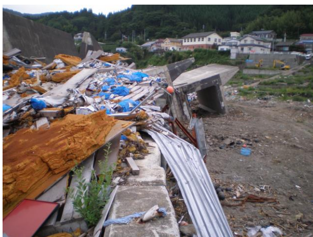
【崩落したままの小白浜の堤防】
