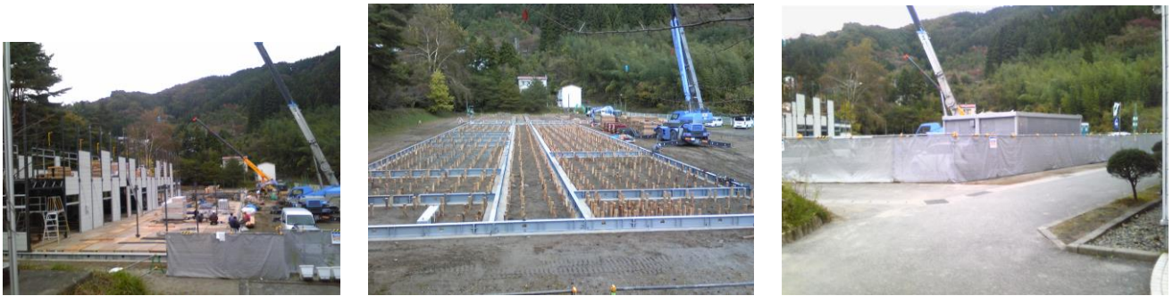
【仮設校舎建設中の唐丹小中学校 photo：唐丹中学校藤館茂校長】
